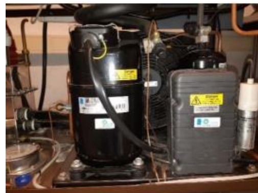
Figuur 8: Compressor ten behoeve van koelen
