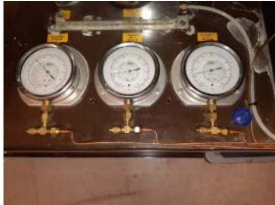
Figuur 12: Manometers voor aflezen van de verdamper- en compressordrukken
